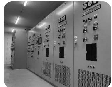
設備更新した第1水源地 （令和2年度完成）
