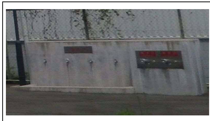
写真 2-3 緊急給水設備（第4水源地内）
