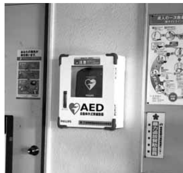
中央公民館に設置されたAED
