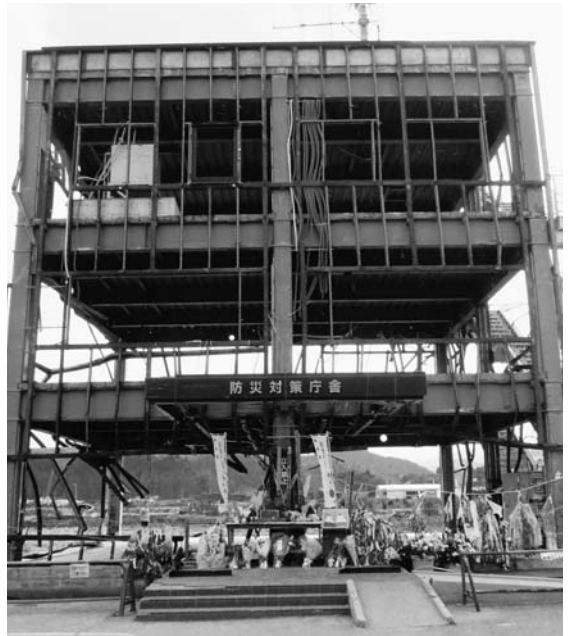
南三陸町防災対策庁舎
